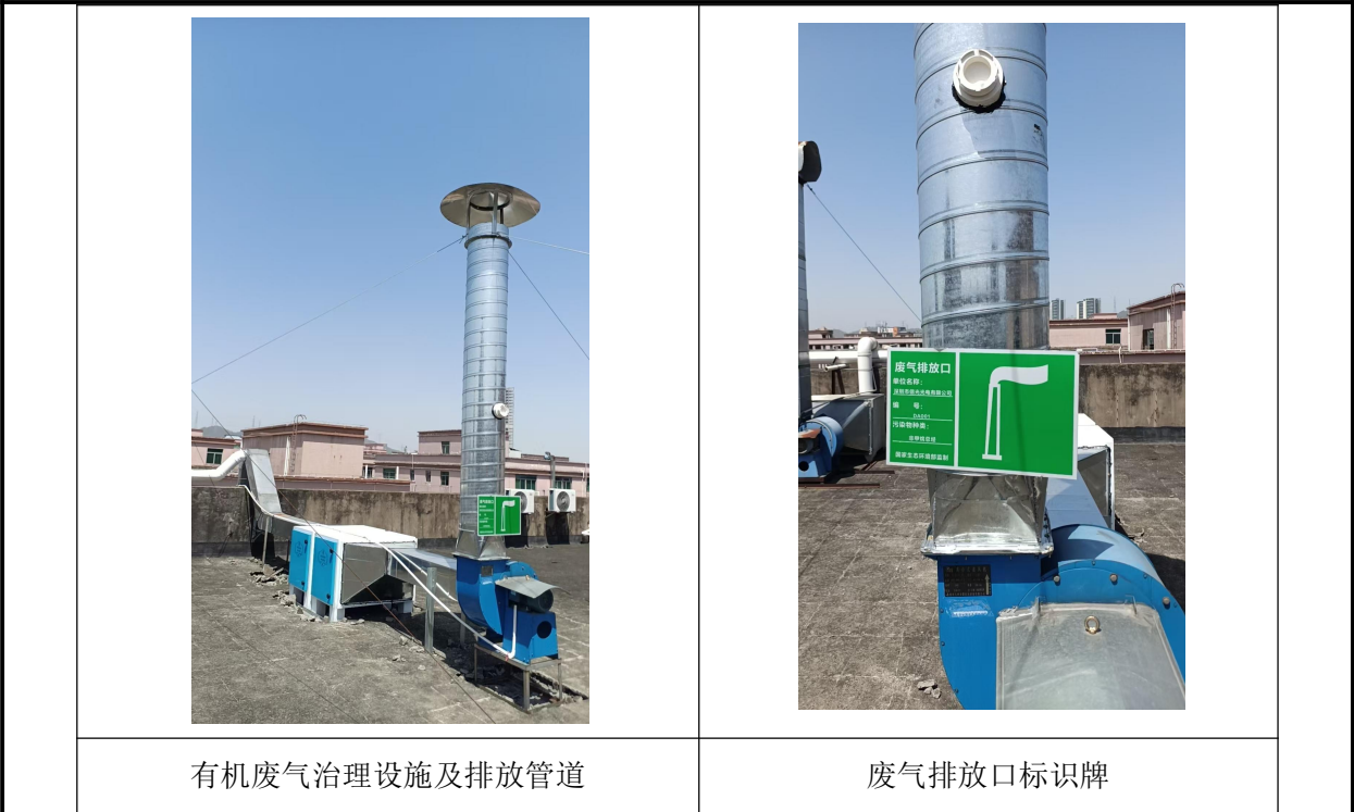
图 2-7 废气治理设施图片
