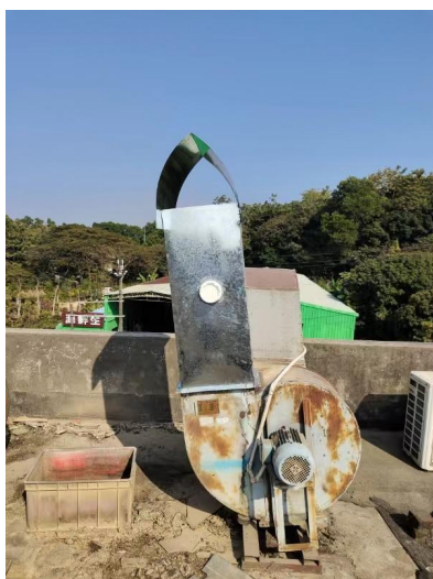
有机废气排放管道
