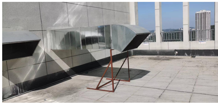
焊锡、有机废气排放管道 图 2-7 废气治理设施图片
