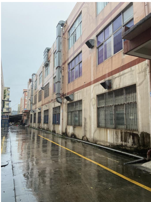
废气排放管道
