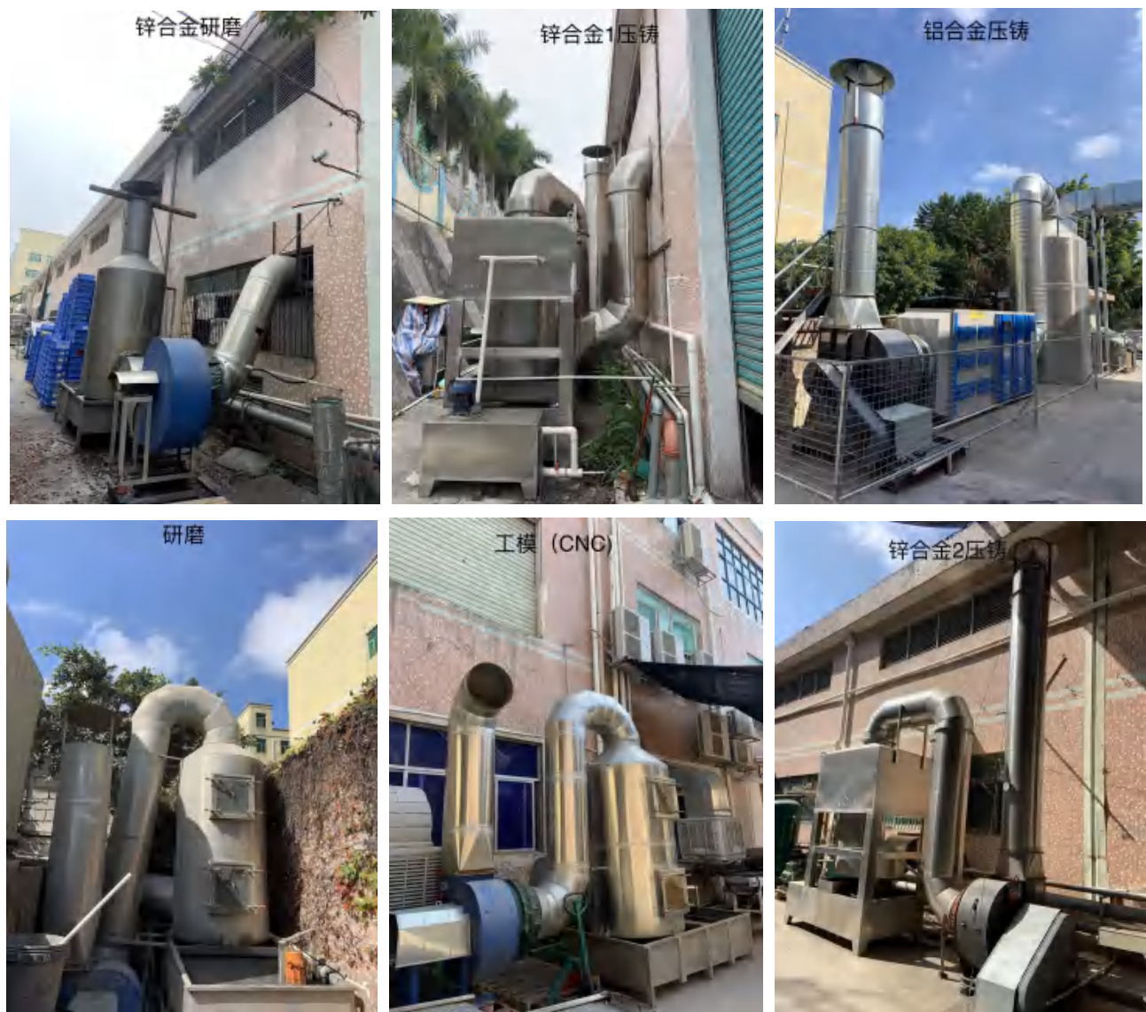
图 3-3 废气处理设施
