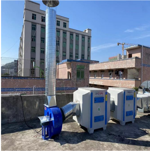
废气处理设施
