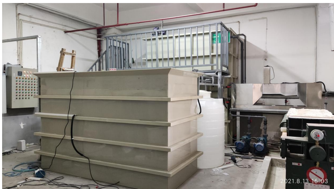
图3 项目升级废水处理设施
